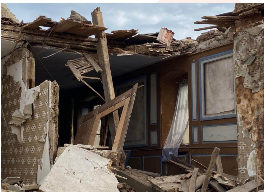
Les boiseries de la chapelle du 18ème siècle n'ont même pas été déposées et sont pulvérisées par l'engin du démolisseur !
